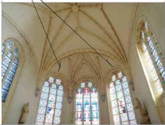
Figure 1 Fissuration des voûtes du chœur
