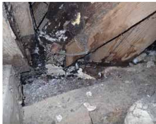
Figure 4 Pied de nef Sud-Ouest dégradée
